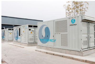
工商业园区储能
